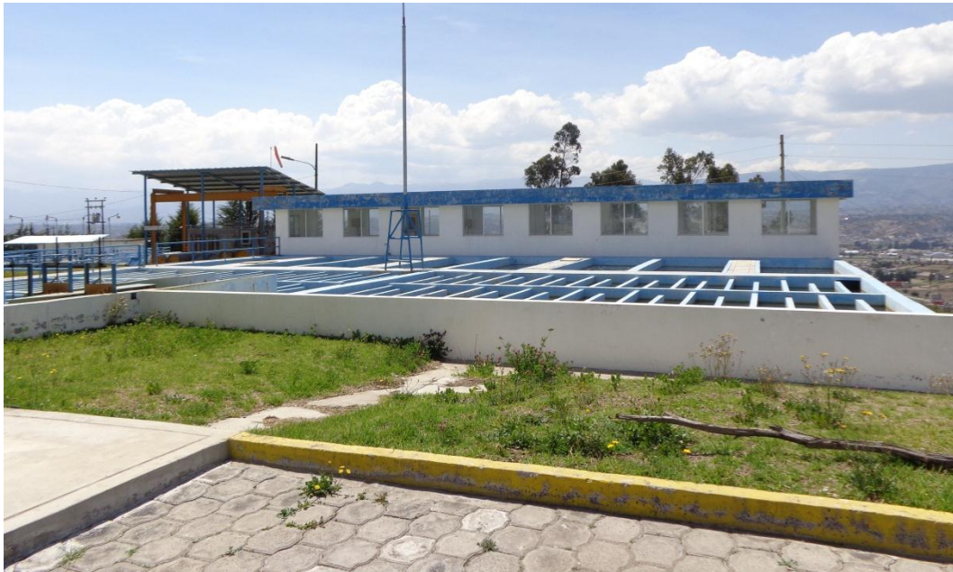
Figura 9. PLANTA DE TRATAMIENTO LOMA DE ALCOCERES.
