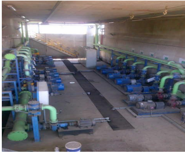
IMAGEN N° 1: Cuarto de bombas vista frontal
