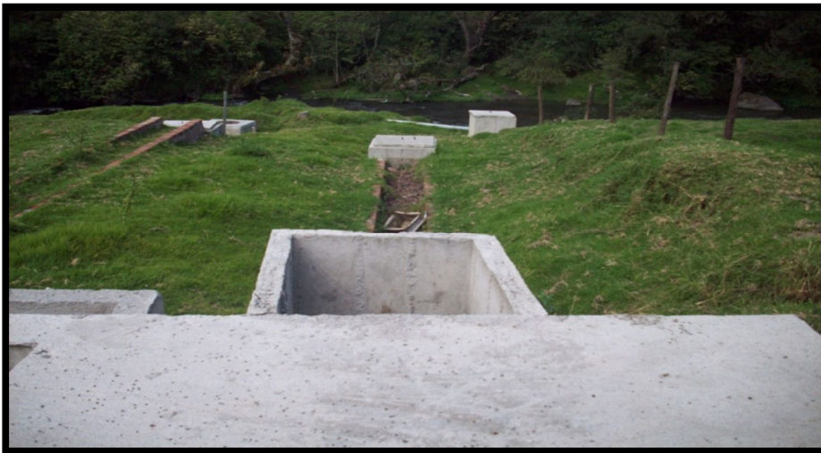
Anexo 4. Fotografía de tanque de almacenamiento Fuente: Nelly Lescano
