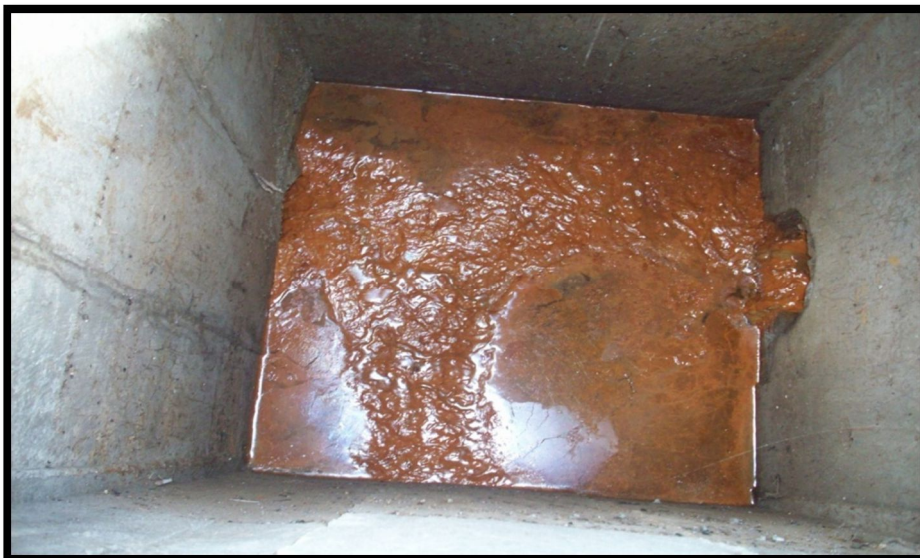
Anexo 10. Fotografía de tanque de almacenamiento Fuente: Nelly Lescano
