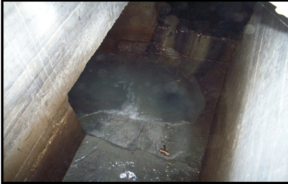
Anexo 1. Fotografía de fin del Alcantarillado del Barrio el Rosal Fuente: Nelly Lescano
