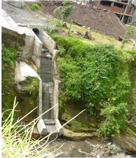
Aguas servidas canalizadas a la quebrada
