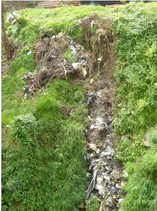
Presencia de desechos sólidos en la laderas de la quebrada.
