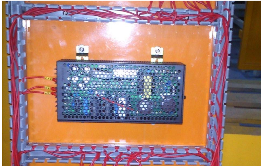
FIGURA 3.10 Fuente de alimentación de 24 AC/ DC
