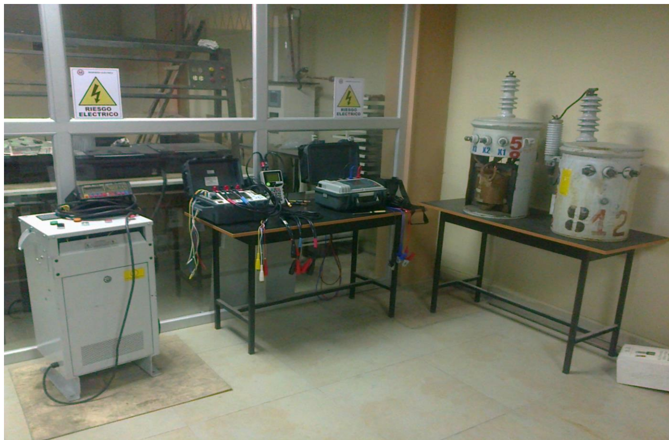
Anexo 9.- Equipos de Alto Voltaje.
