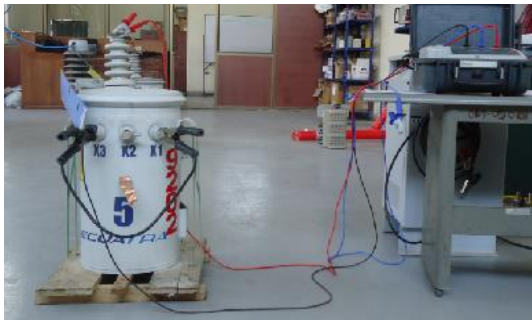
Conexión del transformador monofasico y el MEGGER MIT520/2.
