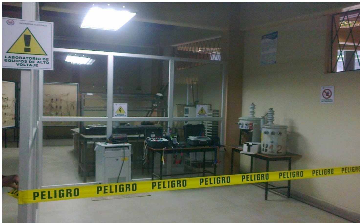
Anexo 10: Laboratorio de alto voltaje de la carrera de Ingeniería Eléctrica de la UTC.
