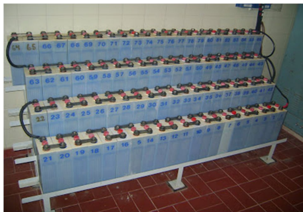
Figura 1. 17 Banco de baterías
