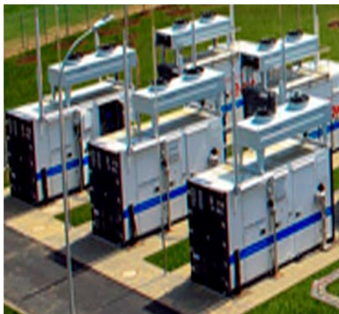
Figura 1. 18 Almacenador de energía
