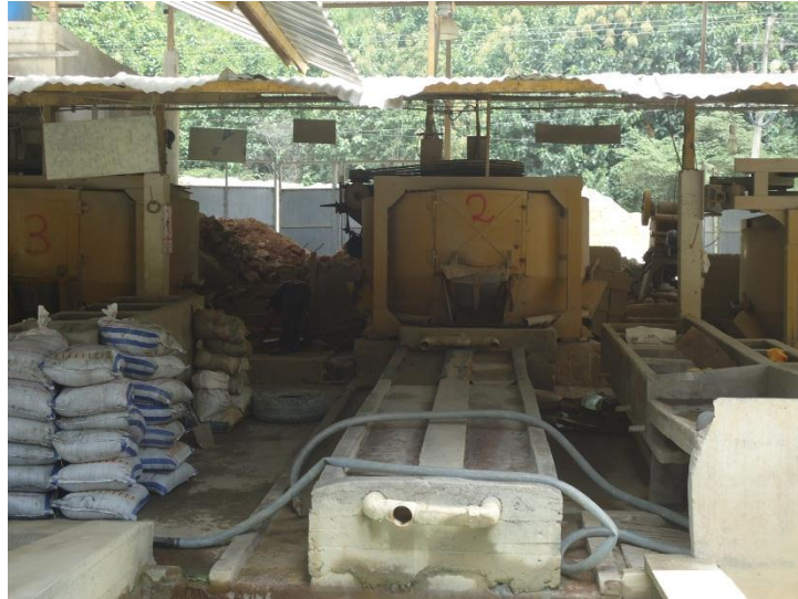
Ilustración 4: Área de Molienda y Trituración
