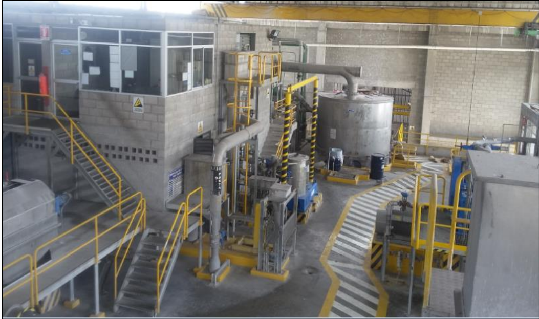
Fotografía 19. Cuarto de control PP5
