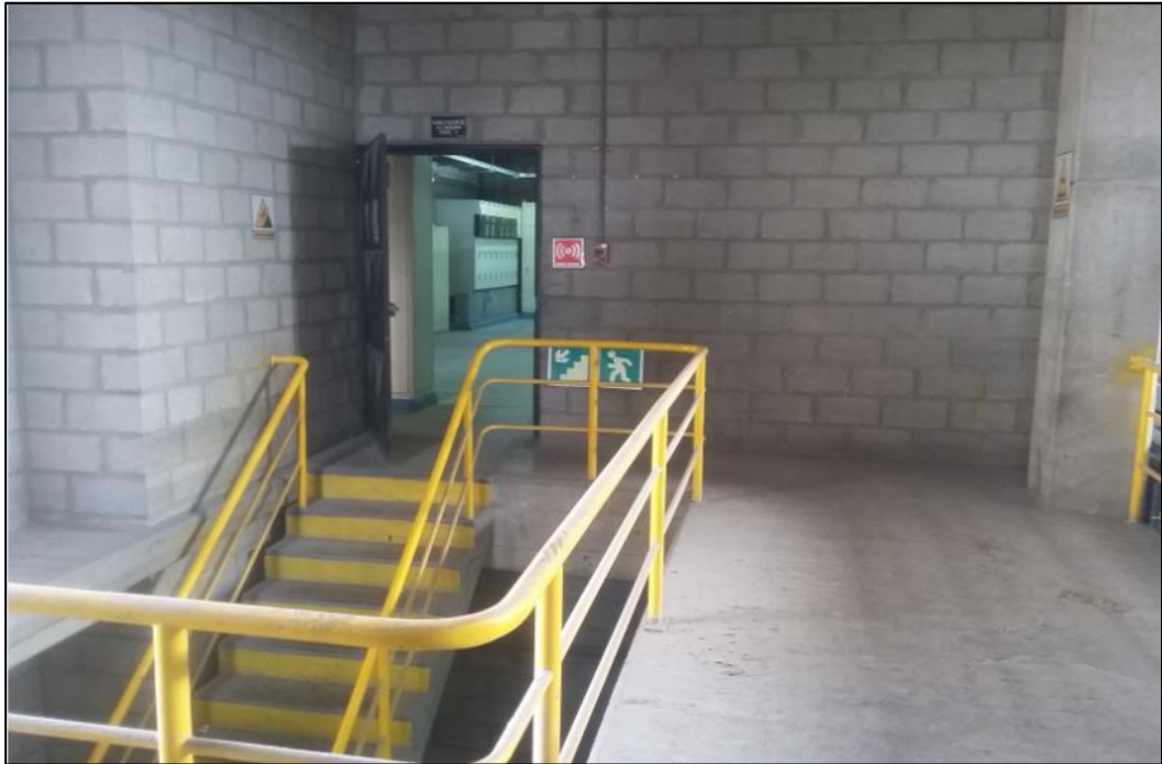
Fotografía 11. Cuarto de control eléctrico parte superior.
