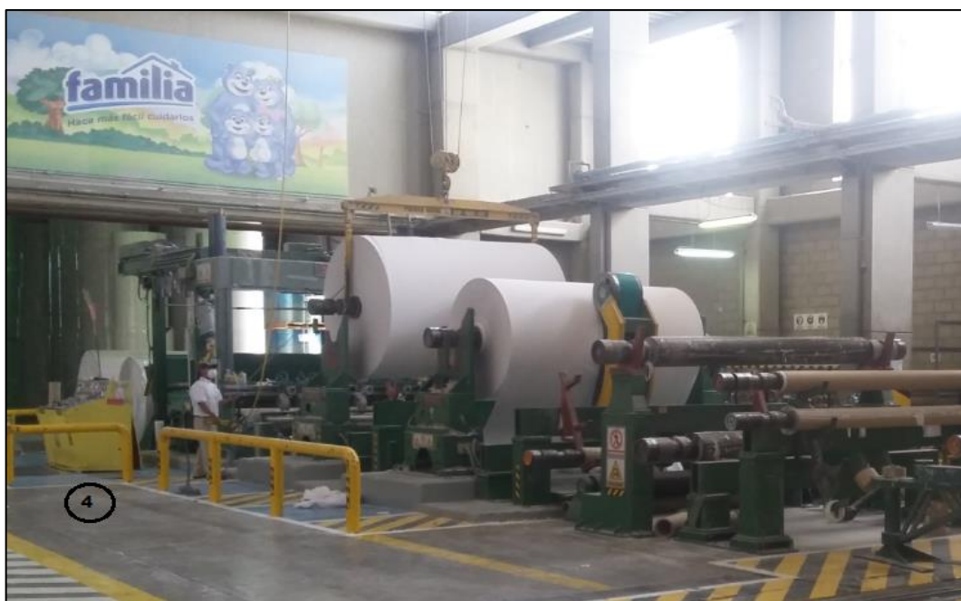
Fotografía 10. Zona Rewinder (rebobinadora).
