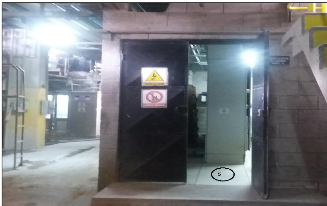
Fotografía 9. Cuarto de control eléctrico.
