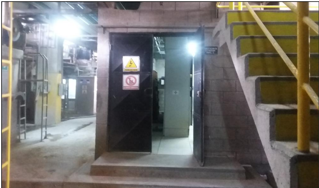
Fotografía 12. Cuarto de control eléctrico parte inferior.
