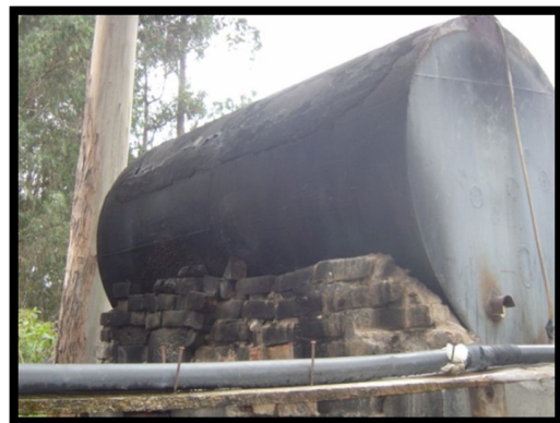
Fotografía 92. Tanque a leña
