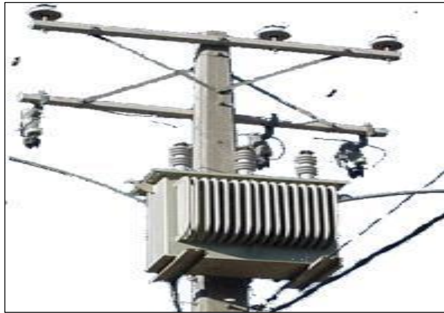
Gráfico 2: Transformador de distribución
