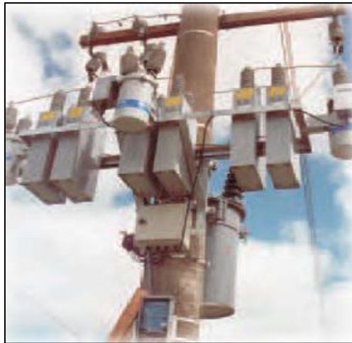
Figura 5: Banco de capacitores fijo en media tensión.
