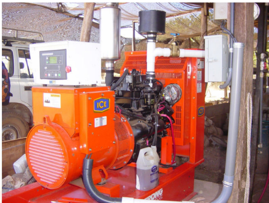
Figura N° 12 Generador a diesel.
