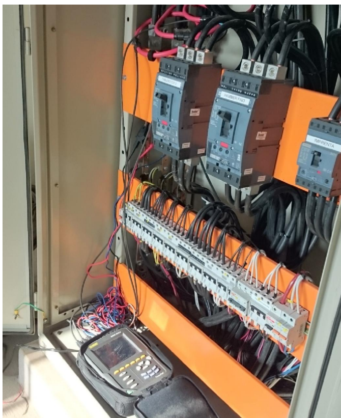
Figura 6. Analizador de carga instalado en TPD
