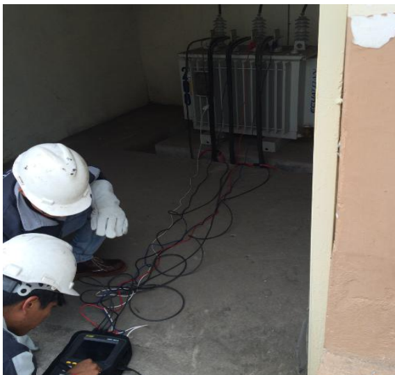
FIGURA 2 INSTALACIÓN DEL ANALIZADOR DE ENERGÍA AEMC 3945 EN EL TRANSFORMADOR DE 200KVA
