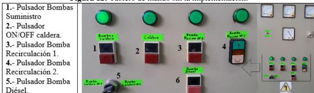
Figura 12: Tablero de mando sin la implementación.
