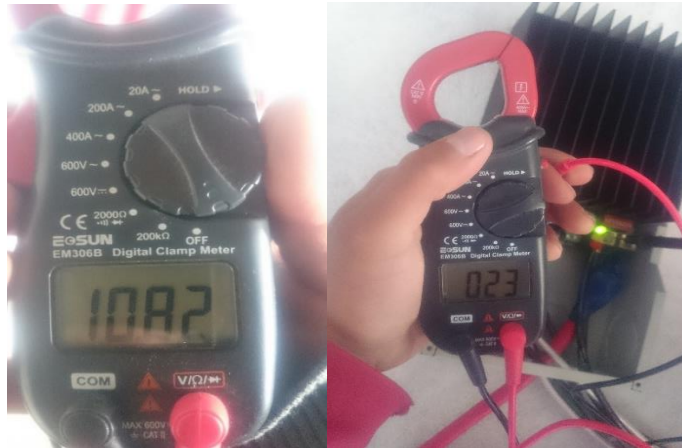
Figura 24: Mediciones de corriente y voltaje del sistema.
