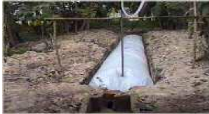
Figura 4 Biodigestor de ESTRUCTURA FLEXIBLE
