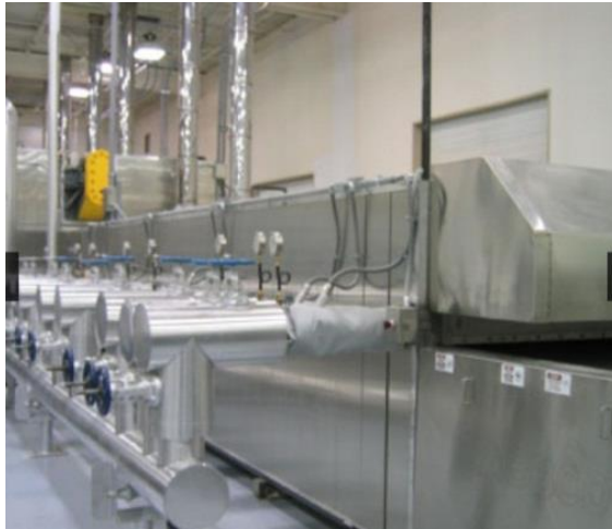
Figura 9. Secador túnel de combustible dual
