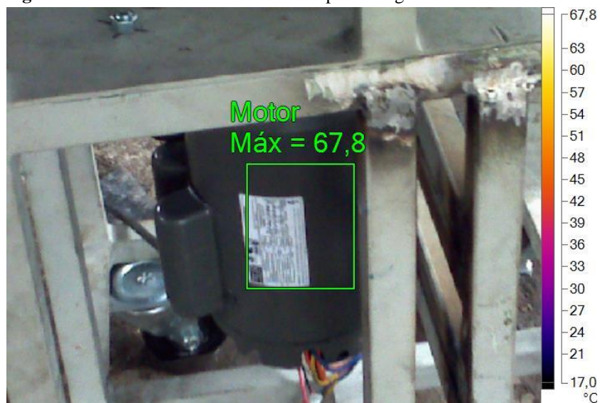
Figura 29: Medición térmica del motor a plena carga
