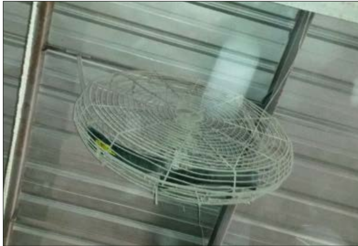
Figura N° 10 Ventiladores ubicados dentro del galpón para enfriamiento
