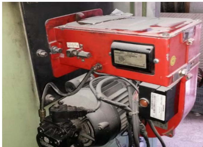
Figura N° 9 Encendedor de llamas para el calefactor y control de temperaturas bajas.
