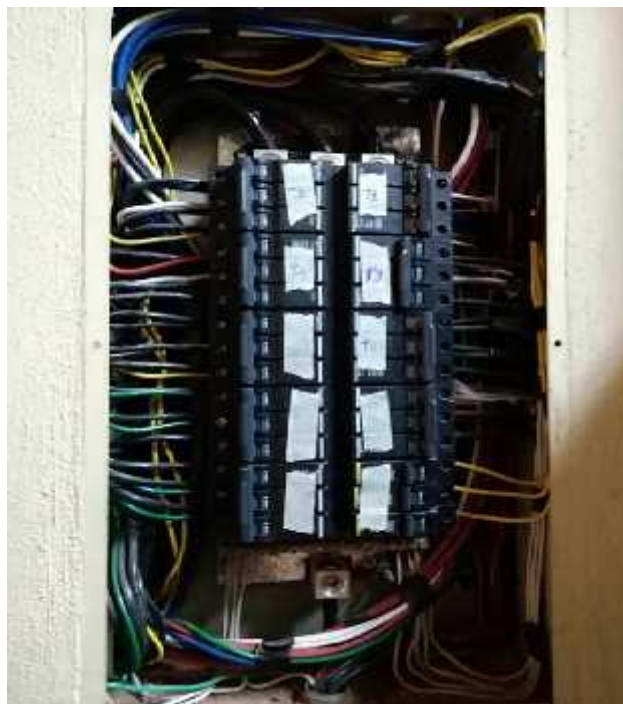
Fotografía 8: Centro de carga adecuados e implementados
