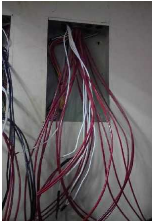
Fotografía 6: Estado de centro de carga en los laboratorios
