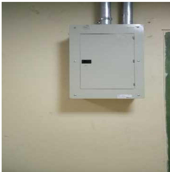
Fotografía10: Centro de carga implementado
