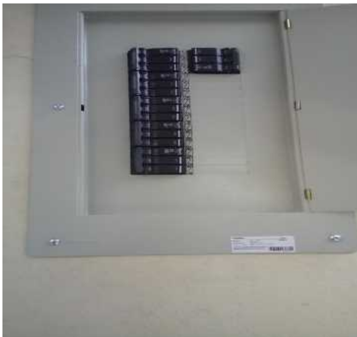
Fotografía 9: Centro de carga implementado
