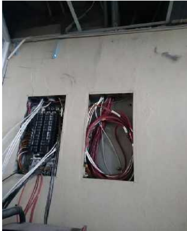
Fotografía 7: Estado que se encontraron los centros de carga
