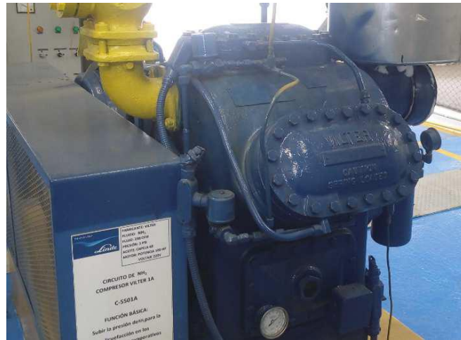
Figura 7. Compresor Vilter 1A
