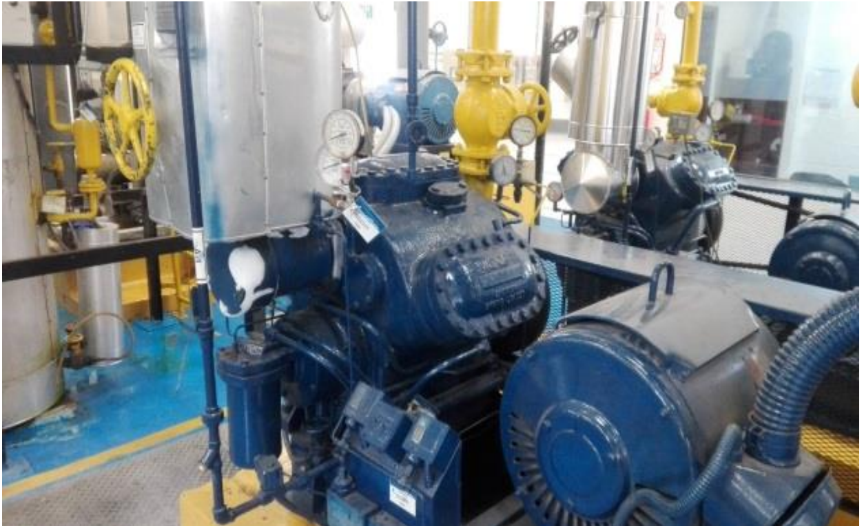
Figura 13. Ubicación de manómetros en compresor Vilter
