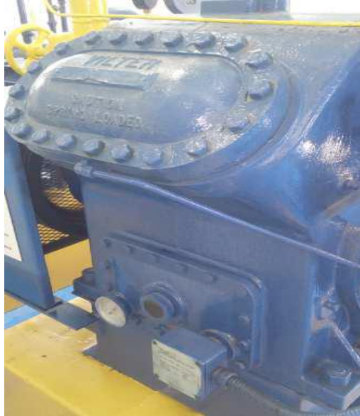
Figura 8. Compresor Vilter 1B
