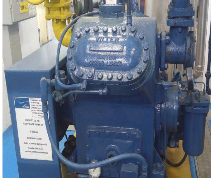
Figura 9. Compresor Vilter 2A
