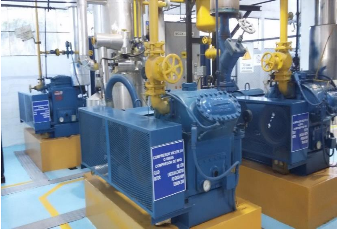
Figura 6. Compresores Vilter Existentes
