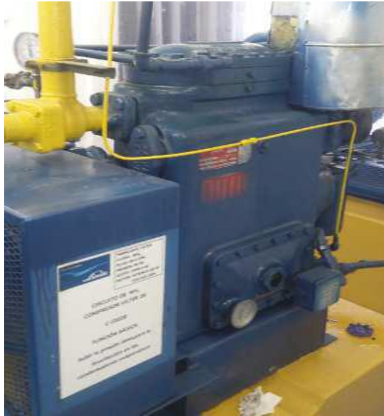
Figura 10. Compresor Vilter 2B
