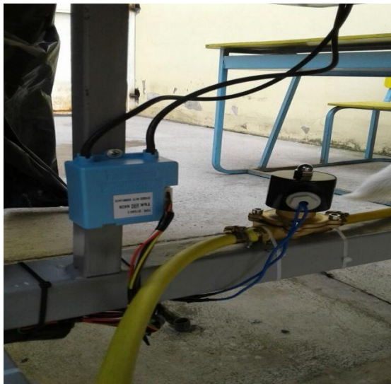
Sistema de encendido y electroválvula (Encendido)
