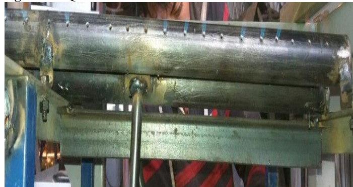
Figura 28: Quemadores de GLP
