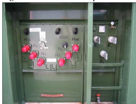
Figura 3. Transformador Tipo Pedestal.
