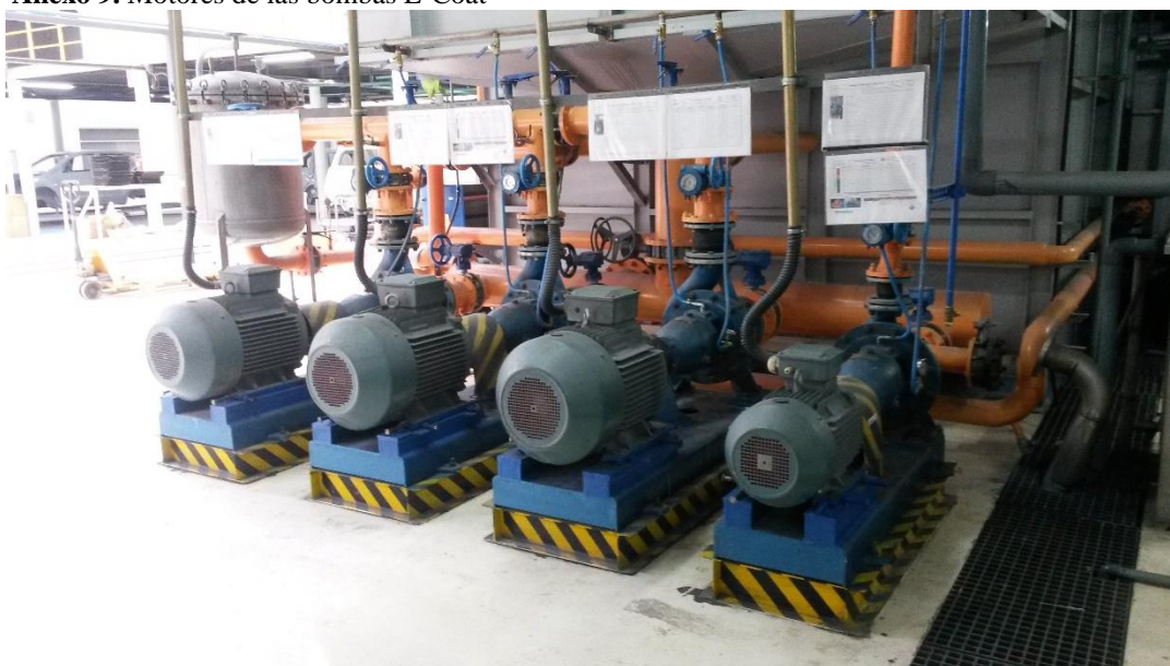
Anexo 9. Motores de las bombas E-Coat
