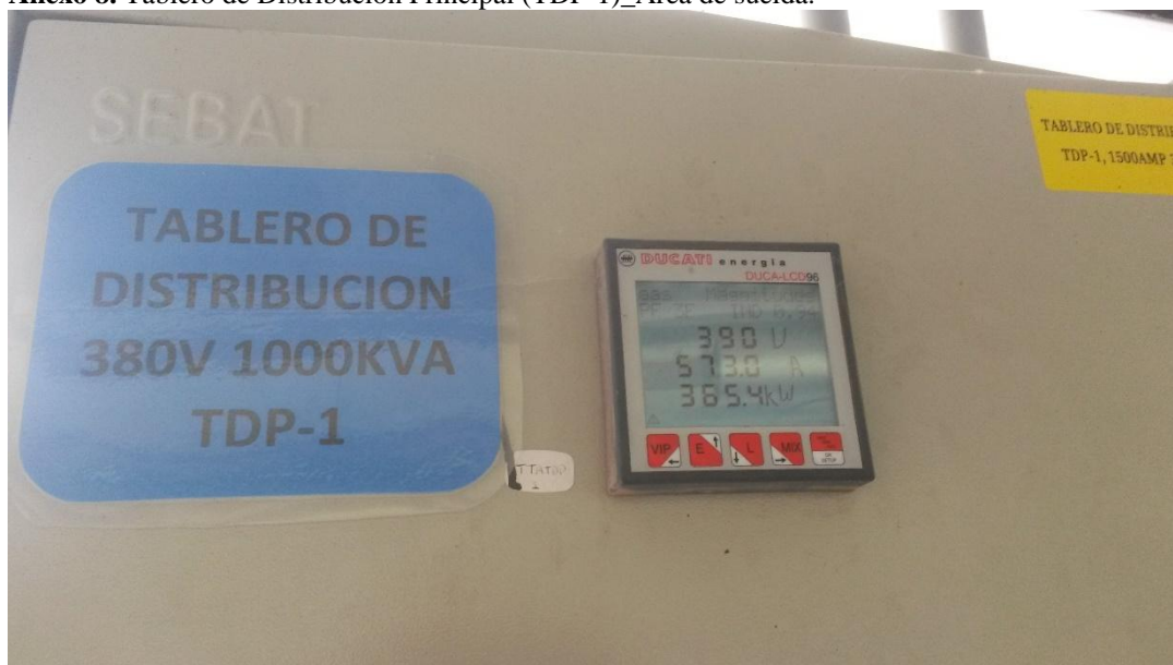
Anexo 8. Tablero de Distribución Principal (TDP-1)_Área de suelda.
