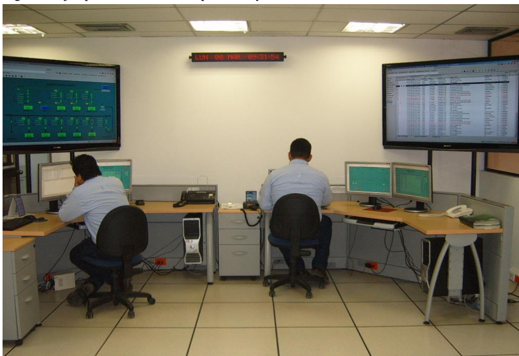
Figura 3. Ejemplo de software de supervisión y control.
