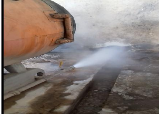
Figura 52. Purga manual no adecuada.
