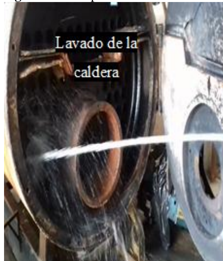
Figura 34. Limpieza de la caldera
