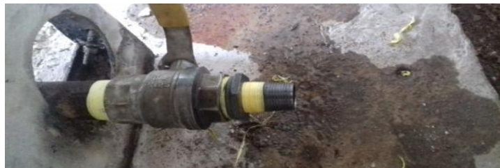
Figura IV. 7. Implementación de la válvula de seguridad.
