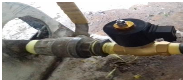
Figura IV. 8. Implementación de las electroválvulas.
