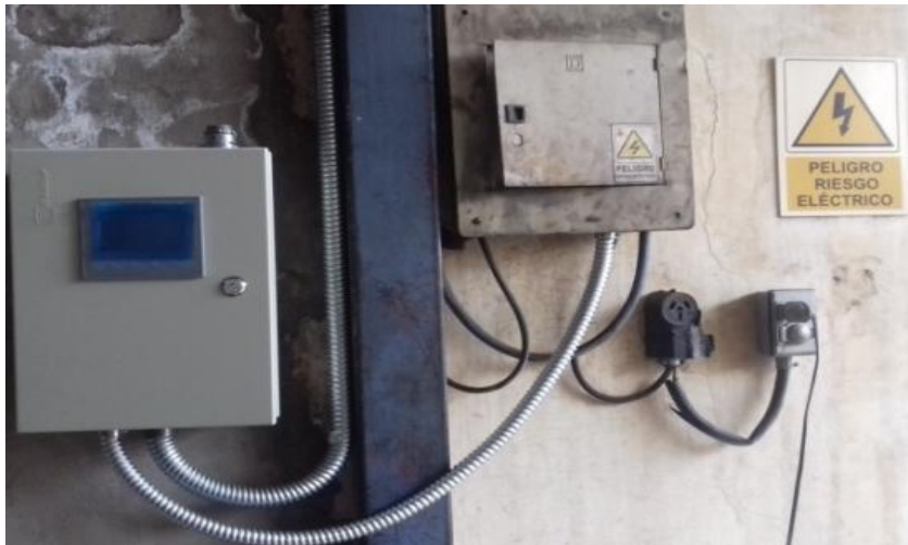
Figura III. 4. Instalación eléctrica del tablero de control e instrumentos
