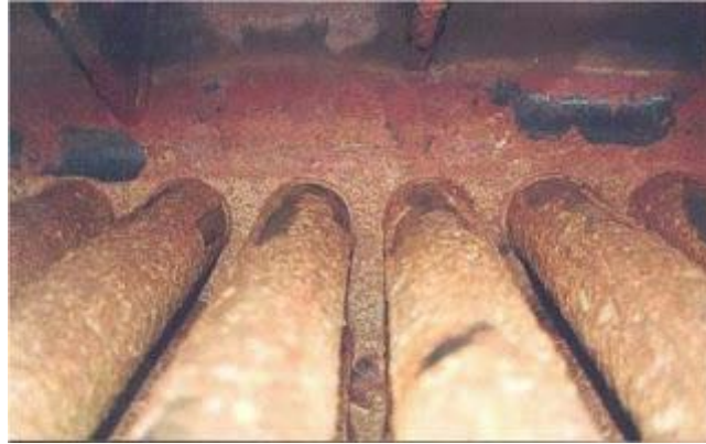
Figura 4. Incrustaciones en la caldera.
