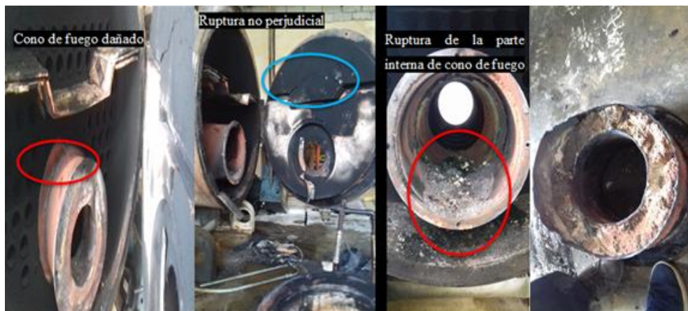
Figura 33. Verificación de los danos internos de la caldera.
