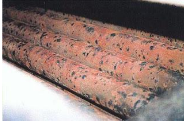
Figura 3. Tubos con corrosión por Oxígeno o “Pitting”.
