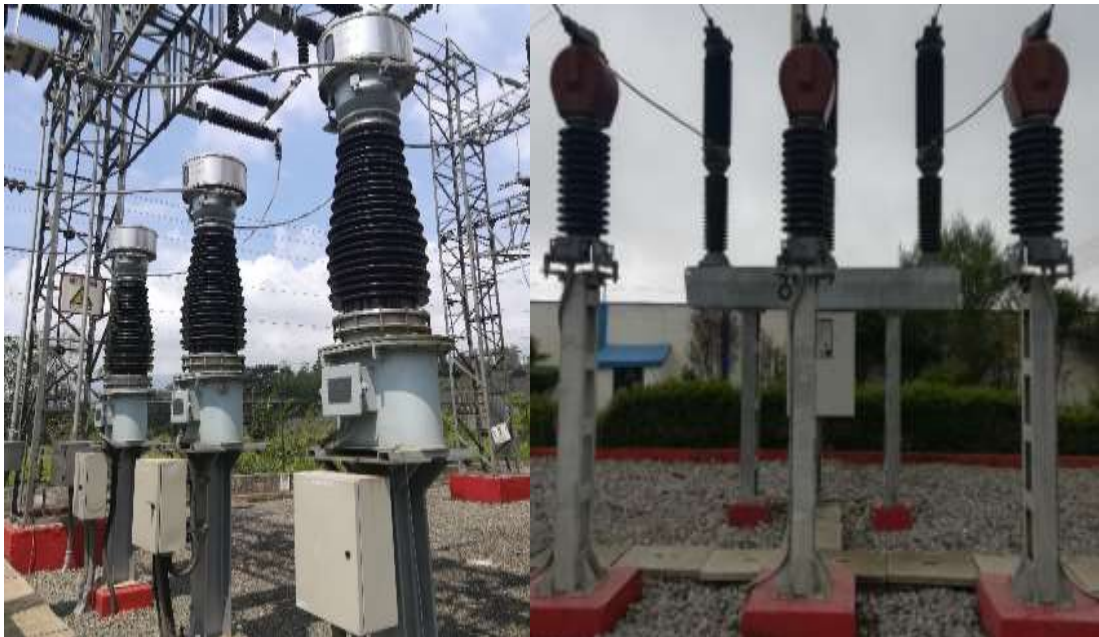
Figura 24. Transformadores de corriente
