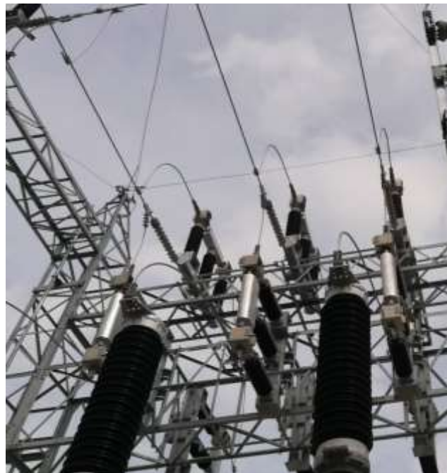
Figura 20. Seccionador de barra (89B)
