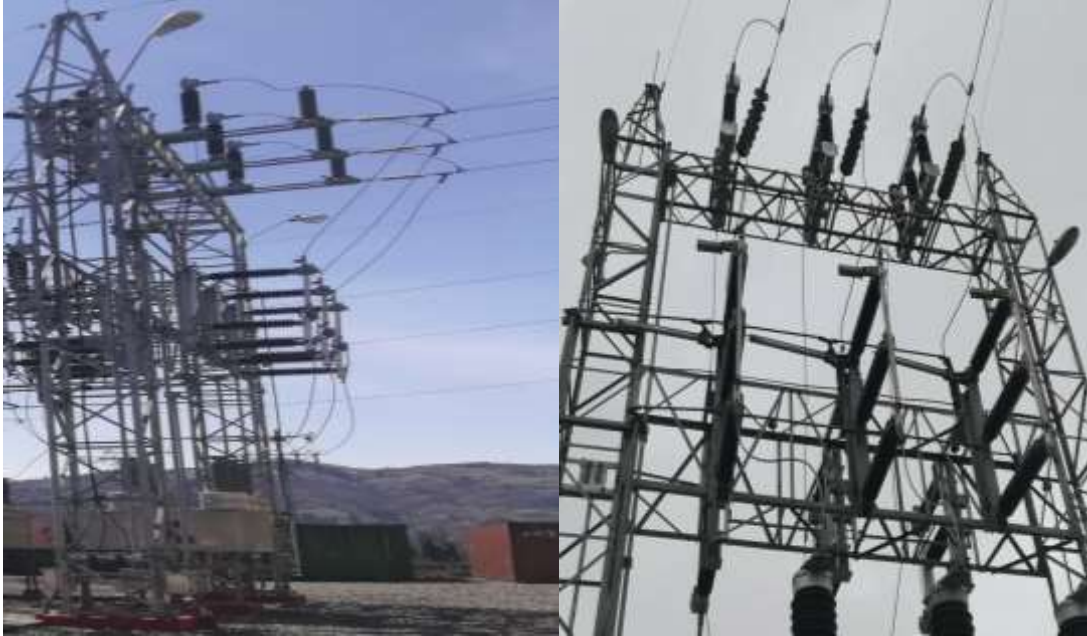
Figura 19. Seccionador de línea (89L)
