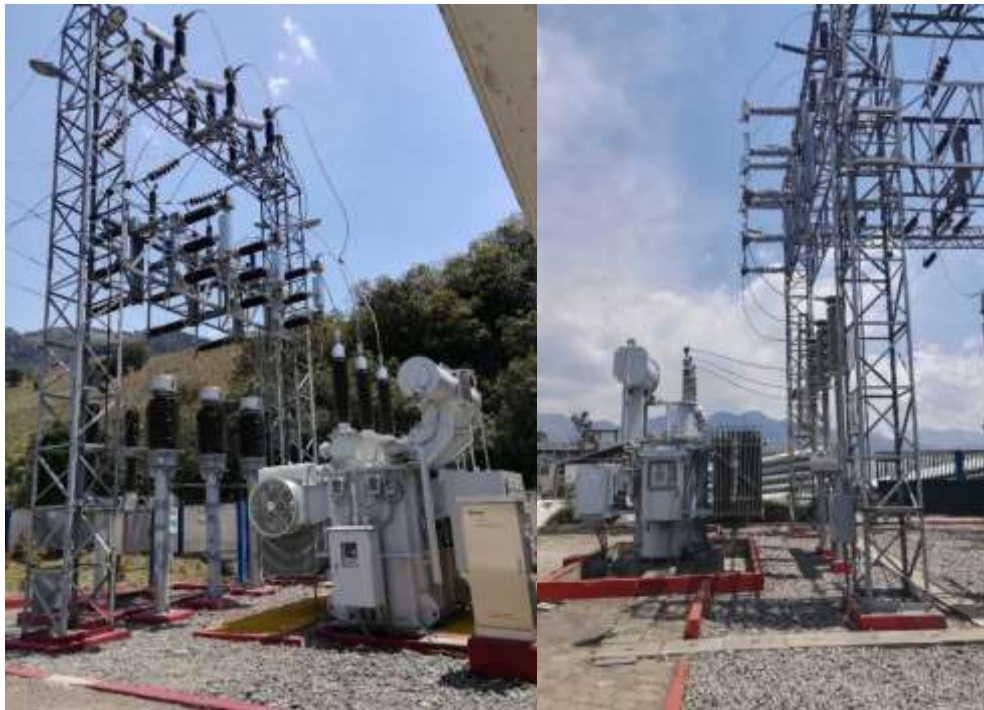
Figura 22. Seccionador del Transformador (89A)
