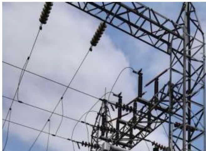
Figura 9. Barras tubulares de una subestación
