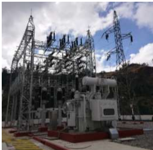
Figura 3. Subestación Eléctrica Guaranda
