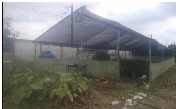
Figura 12: Invernadero donde se va a automatizar
