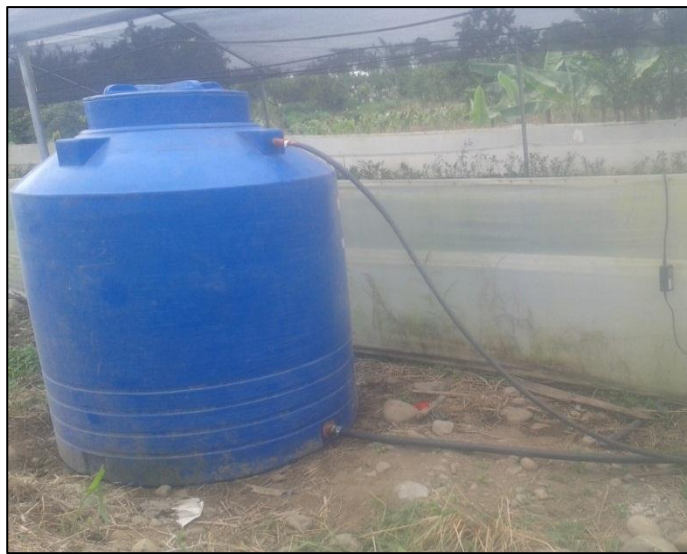
Figura 13: Posición del tanque del invernadero
