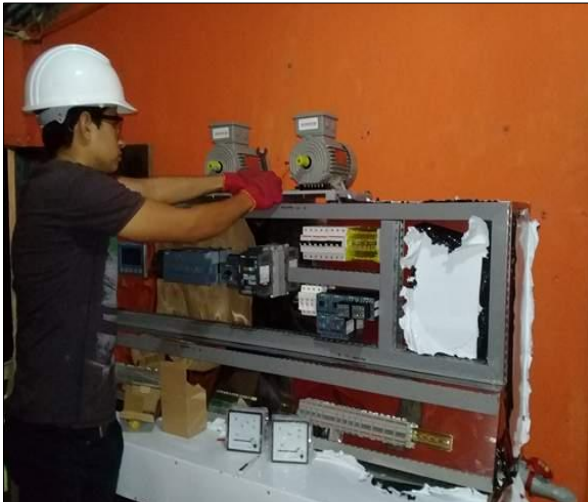
Cableado de PLC S7-1200
