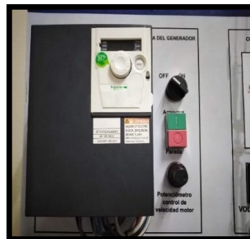
Fig. 3 Variador de frecuencia.
