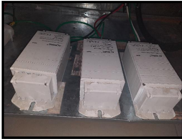
Figura 3.20. Balastros de 250W.
