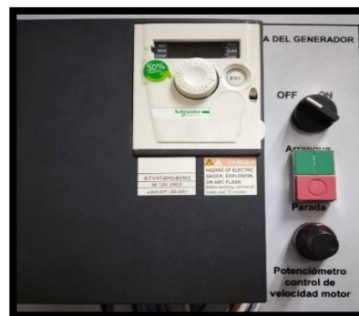
Fig. 3 Variador de frecuencia.
