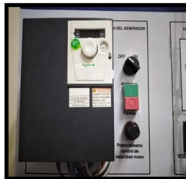
Fig. 3 Variador de frecuencia.
