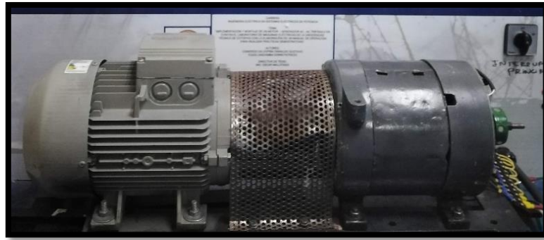
Figura 2.2. Grupo Motor - Generador.
