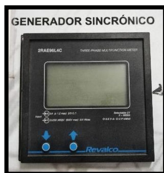
Figura 2.5. Multímetro Digital del Generador.
