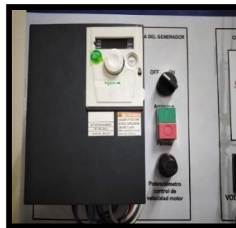
Fig. 3 Variador de frecuencia máquina impulsadora del generador.
