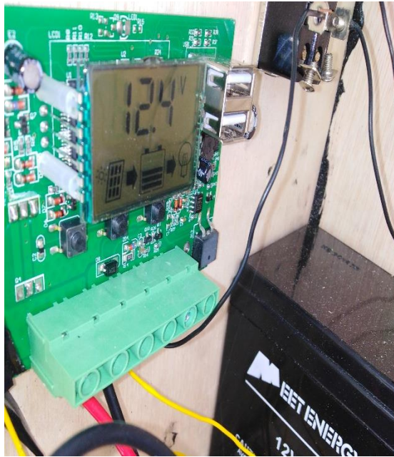
Figura IV.1. Banco de baterías en proceso de carga
