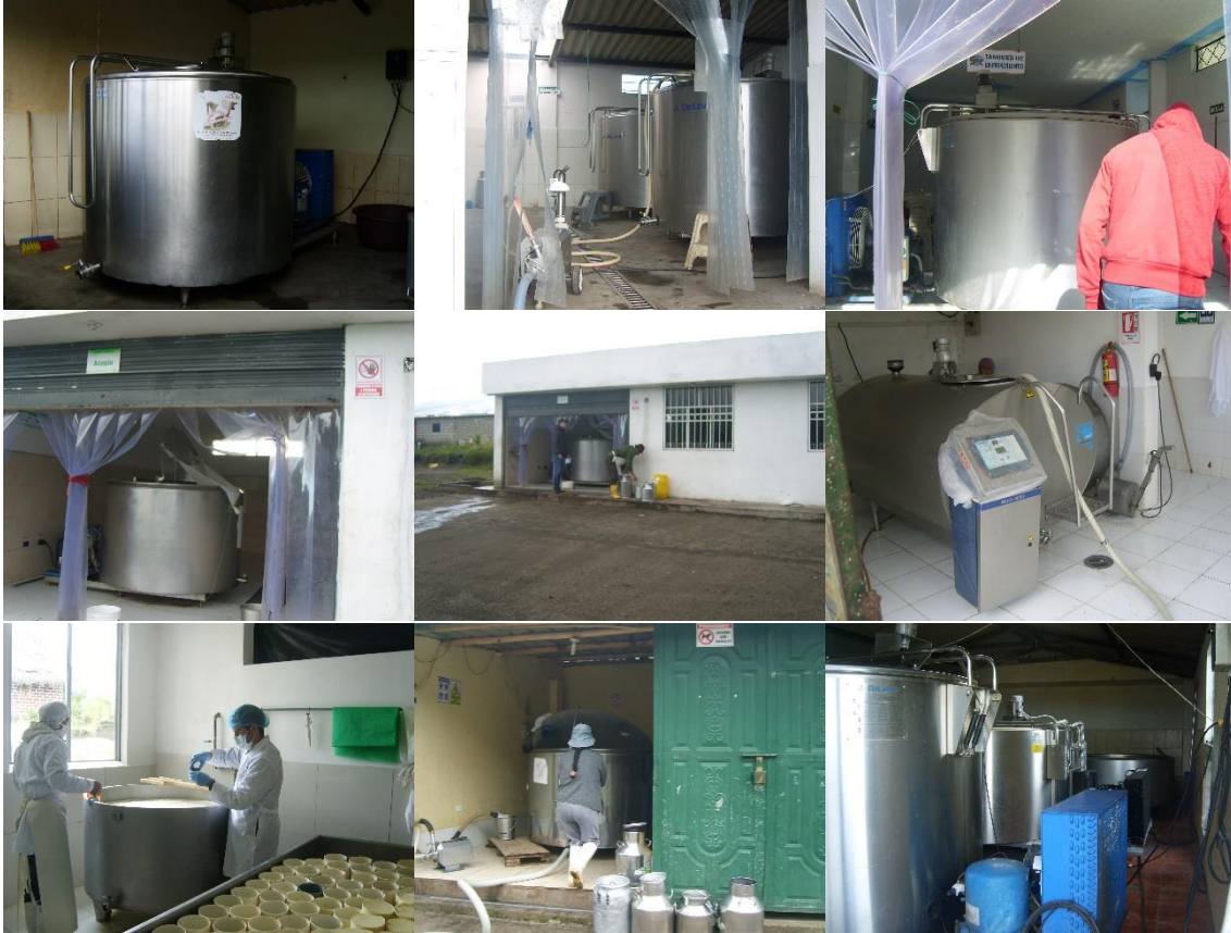
Tanques enfriadores de leche de los distintos centros de acopio.
