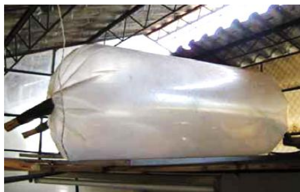
Figura 3.12. Reservorio de biogás.
