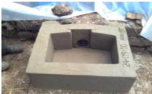
Figura 3.8. Tanque de carga. Fuente: [33].
