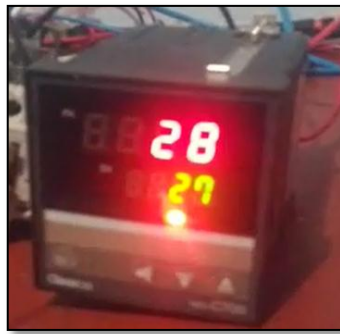
Figura 4. 11. Pruebas del sistema de control
