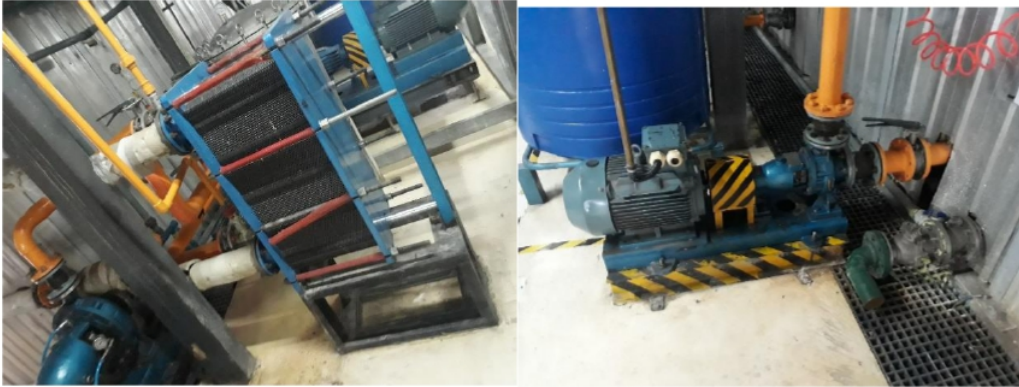
Gráfico 40. Intercambiador de calor, bomba de recirculación
