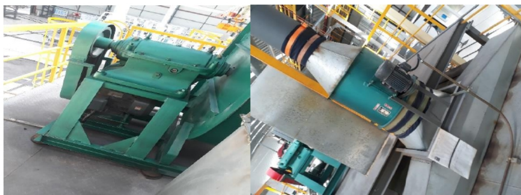
Gráfico 54. Ventilador de enfriamiento M7 y Extractor M6
