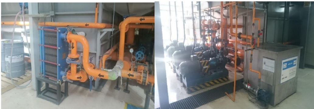
Gráfico 45. Intercambiador de calor y bomba de anolitos.
