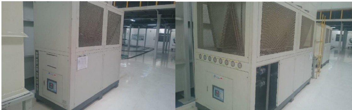
Gráfico 46. Chiller A y B
