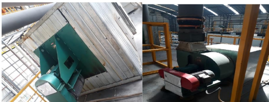
Gráfico 56. Ventilador de casa de aire M4 y Retorno de gases M3
