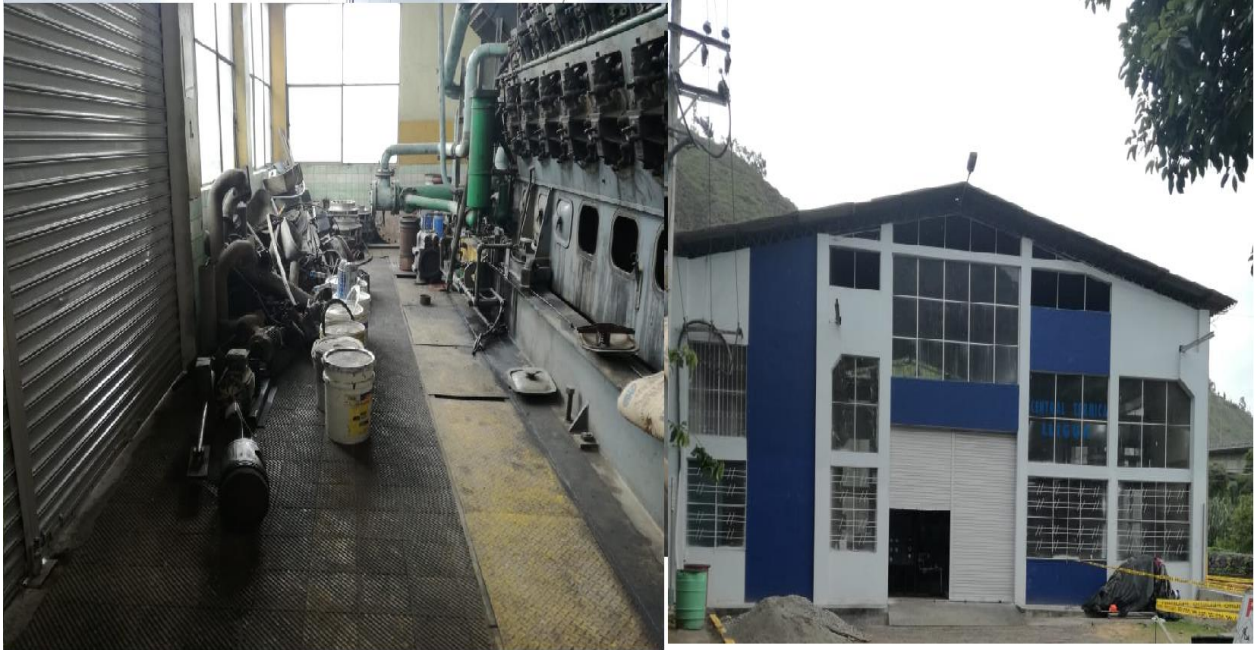
Imagen 14: Térmica Lligua-Subestación La Península
