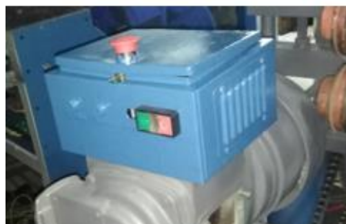
Figura 5.11 Pulsador de Emergencia 2
