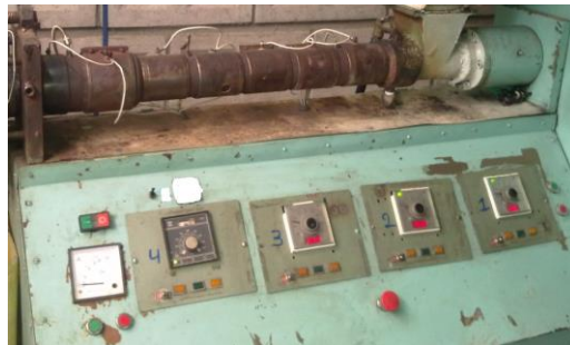
Figura 5.17 Control de temperatura antiguo de la máquina extrusora
