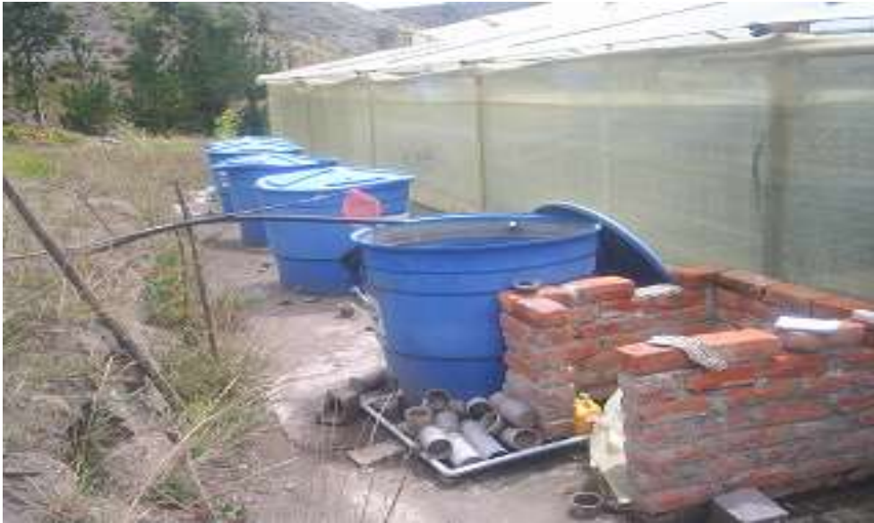
TANQUES RESERVORIOS UTILIZADOS PARA EL SISTEMA DE HUMEDAD
