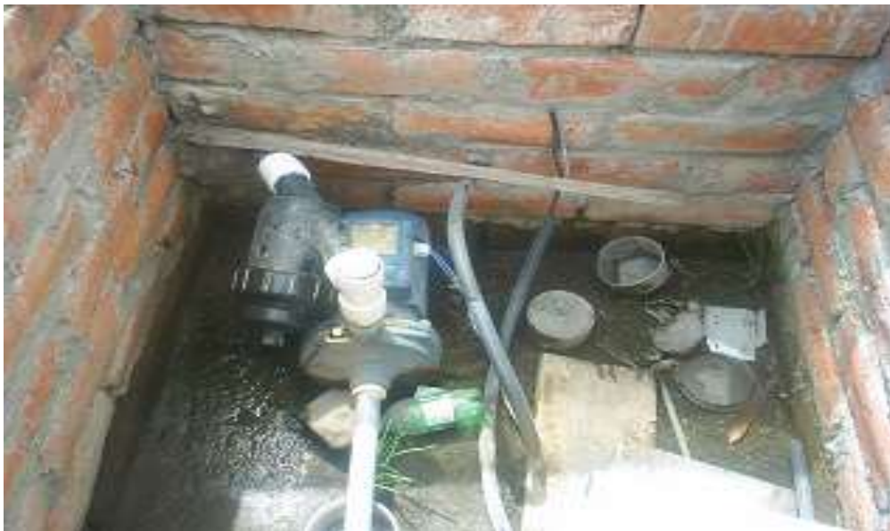
BOMBA HIDRAULICA DEL CRIADERO DE CARACOL
