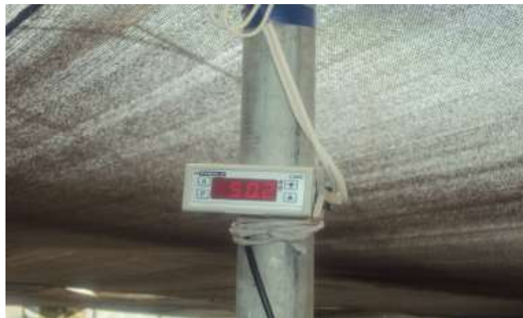
MEDIDOR DE HUMEDAD
