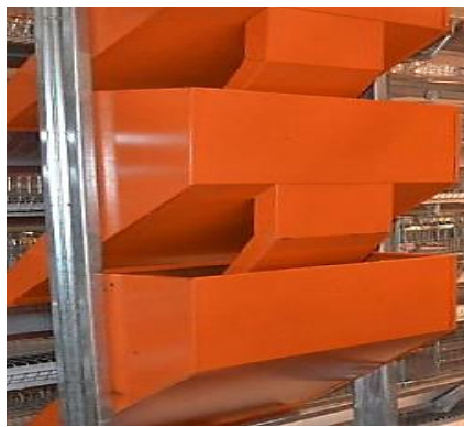
Figura 3.13. Ductos de distribución Fuente: [12]
