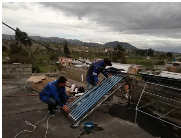
Fig. 4.- Extracción de los tubos de vacío para realizar la limpieza correspondiente
