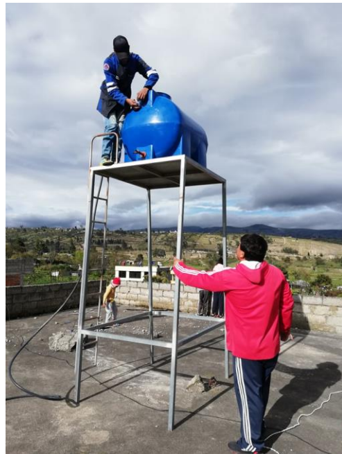
Anexo VI.16.- Conexión de tubería para el abastecimiento de caudal
