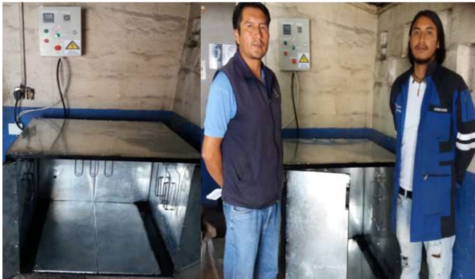
Figura 11. Implementación del horno eléctrico para secado de motores.
