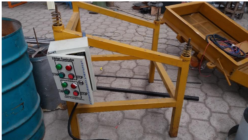
Figura XVI.5. (Ubicación del gabinete de control)
