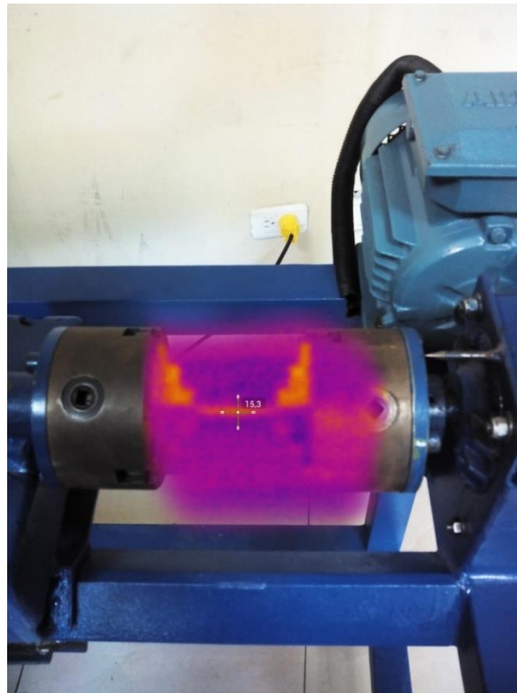
Figura VI.1. Análisis termográfico de la probeta antes del ensayo con una temperatura de 15,3°C
