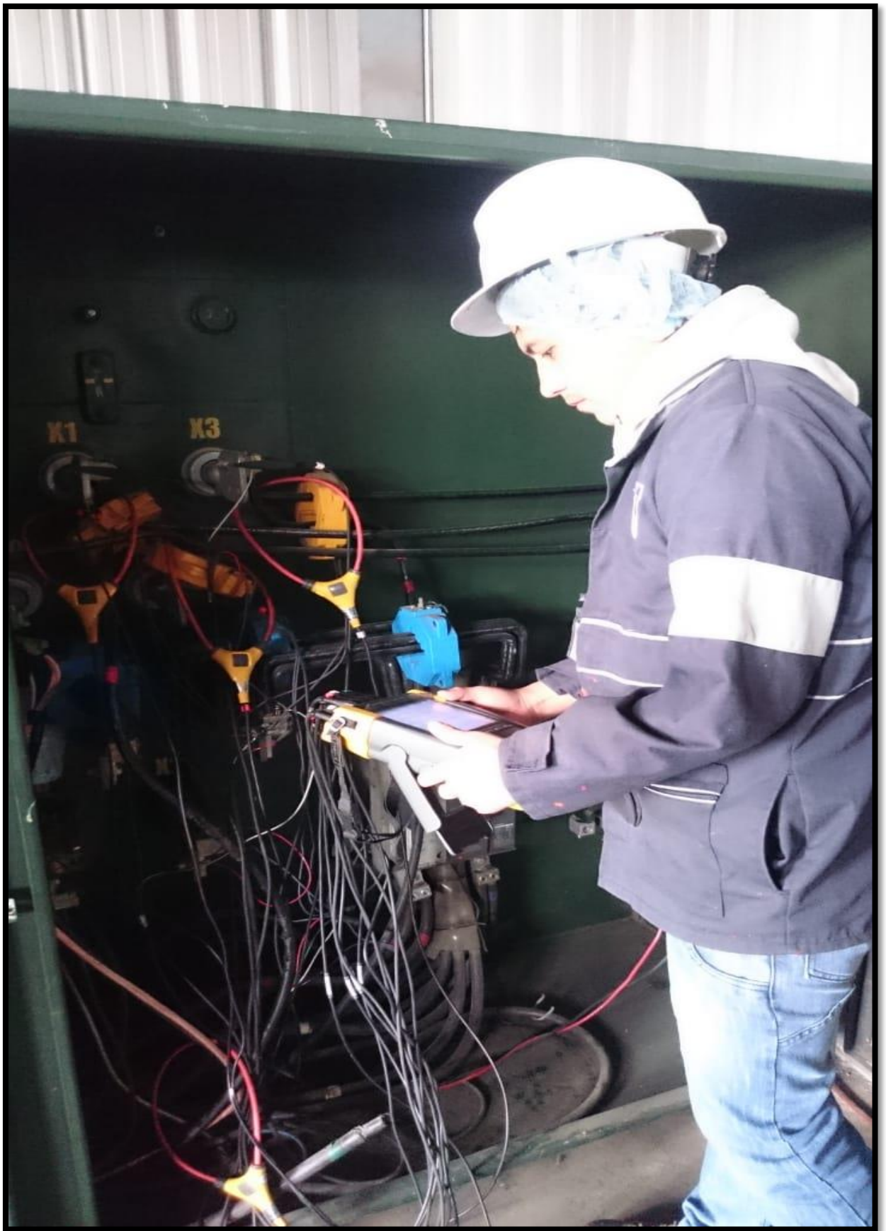
Figura I.X: Instalación del equipo fluke 435 ii
