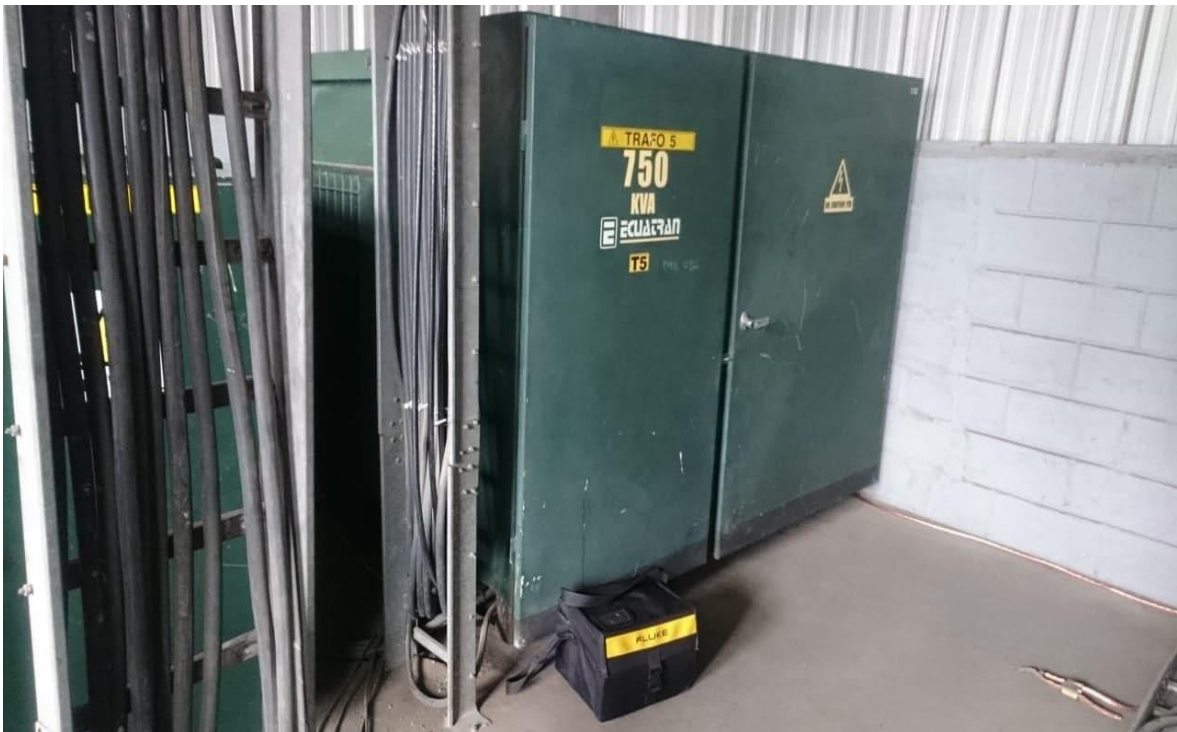
Figura 14: Transformador Trifásico de 750 KVA
