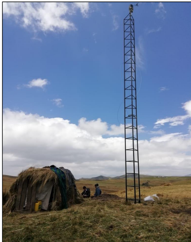
Figura A36. Torre puesta para estudio de potencial eólico
