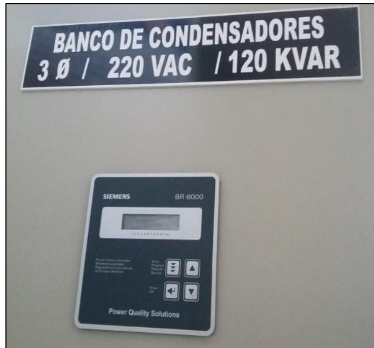
Figura 30: Banco de capacitores de la Universidad
