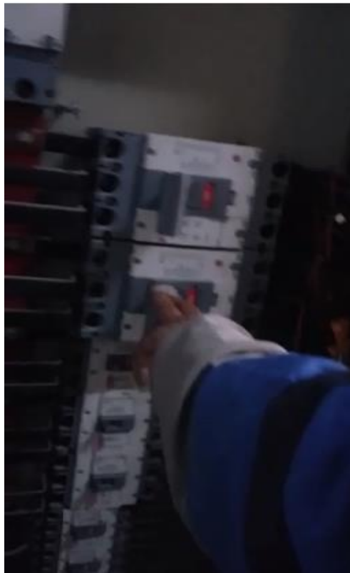
Figura 38: Tablero general de los alimentadores de la universidad
