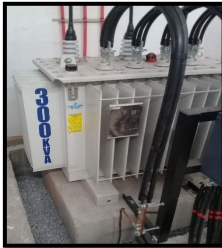
Figura 31: Transformador general de 300 kVA.
