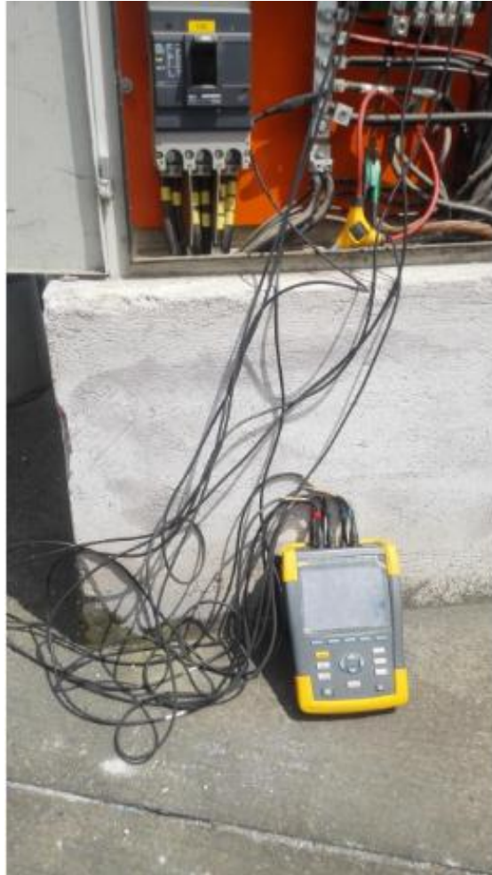
Instalación del analizador en el tablero de distribución de las luminarias de vapor de sodio
