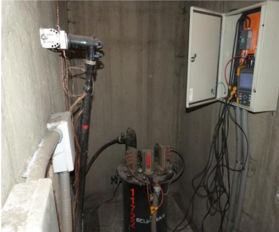
Transformador de 75 kVA de los circuitos de luminarias LED.
