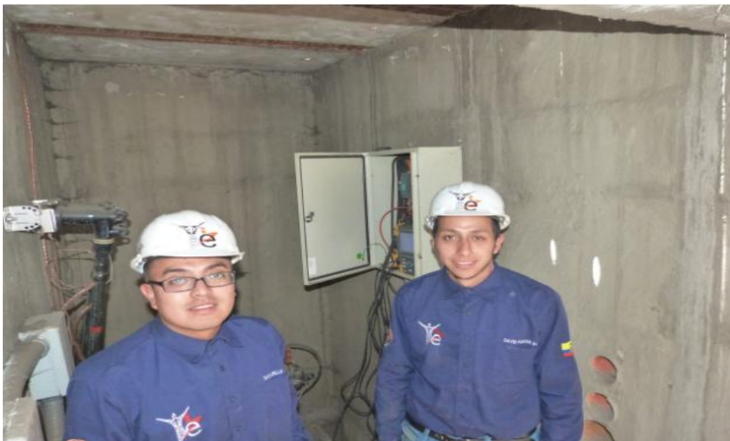
Cámara de transformación de los circuitos de luminarias LED.
