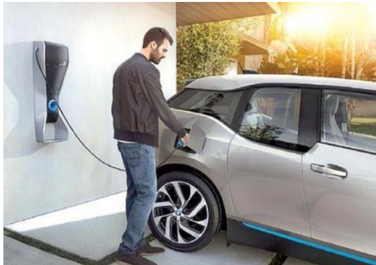
Figura 8.10: Punto de Recarga Privada
